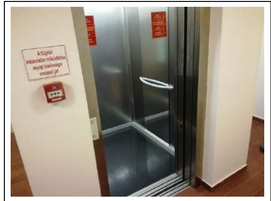
II. emelet – lift és tűzriasztó
