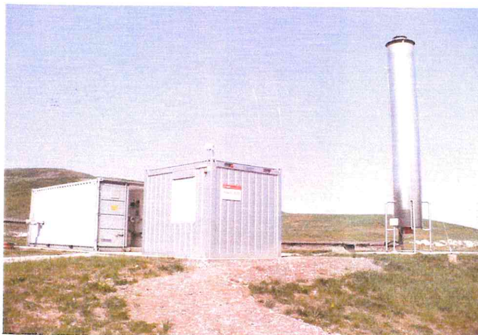
2. ábra: a metángáz semlegesítéséhez telepített berendezések
