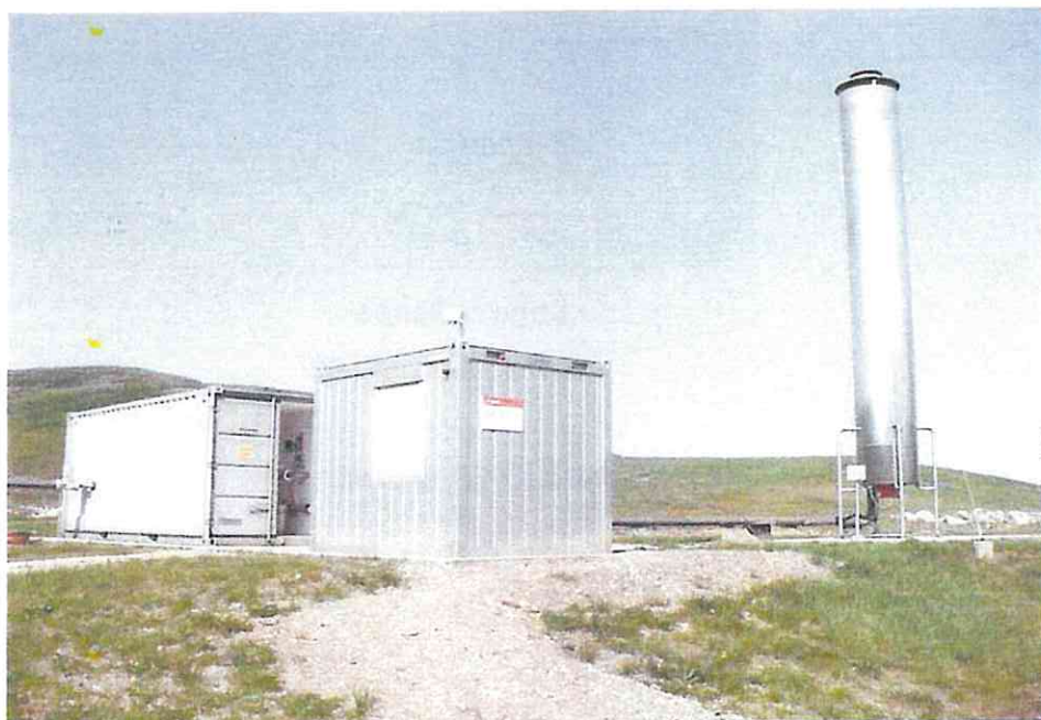
2. ábra: a metángáz semlegesítéséhez telepített berendezések
