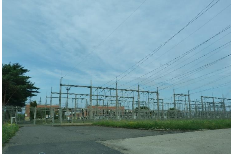
MAVIR ZRt. felelősségi állomása
