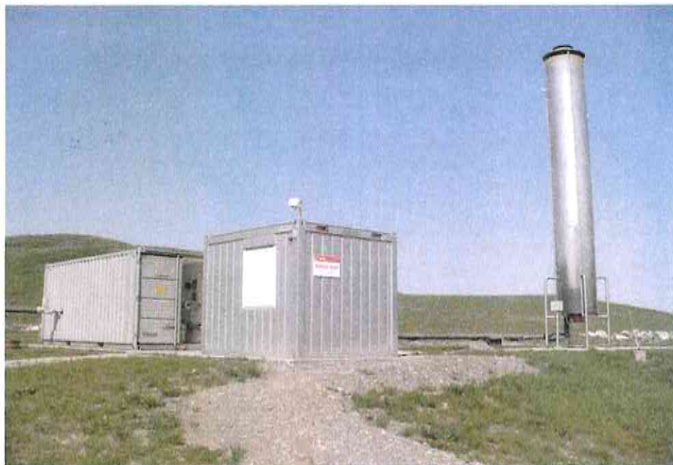
2. ábra: a metángáz semlegesítéséhez telepített berendezések
