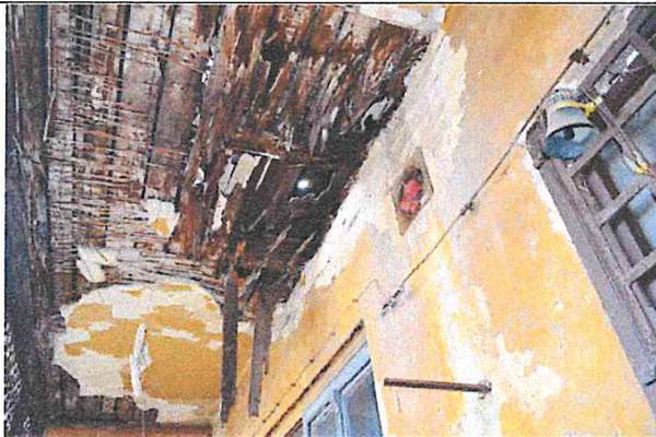
Beszakadt födém / veranda
