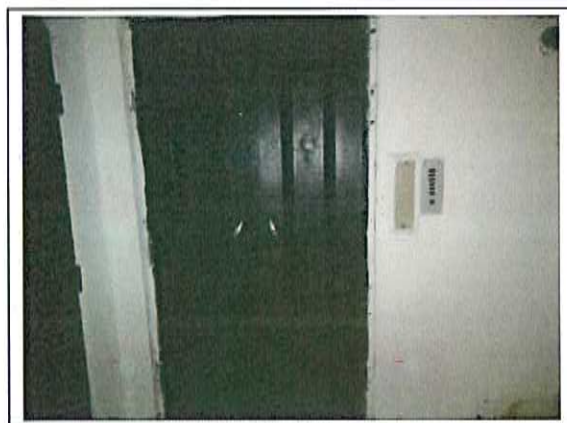
étterem-konyha – teherlift a pince és a földszint között
