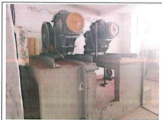
kollégium lift gépház
