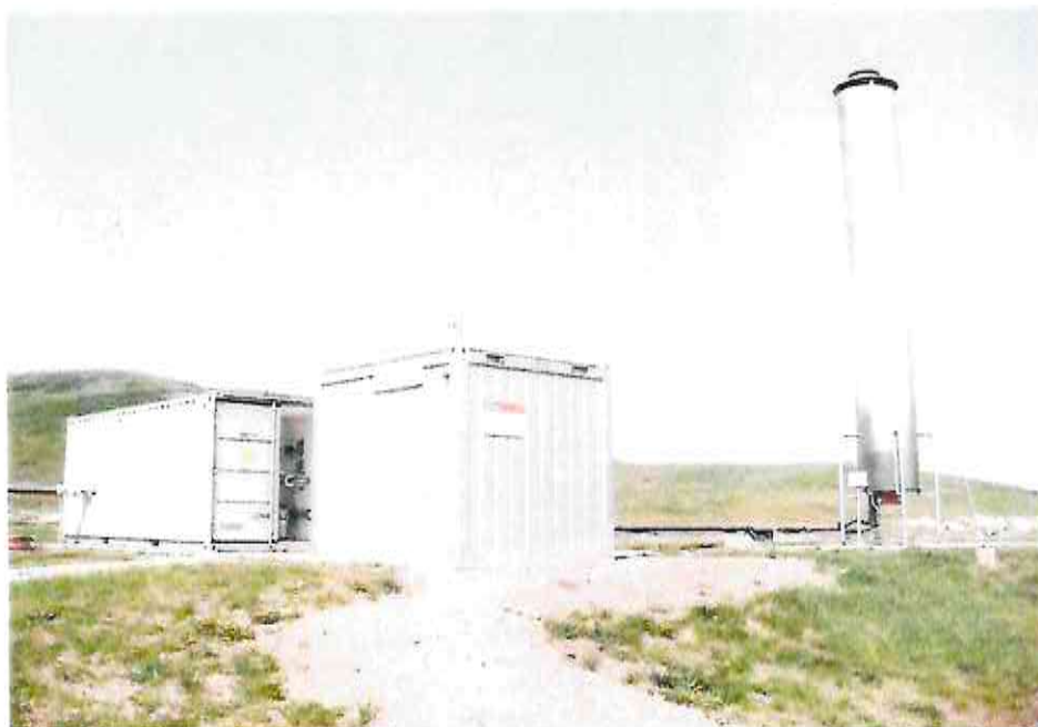
2. ábra: a metángáz semlegesítéséhez telepített berendezések
