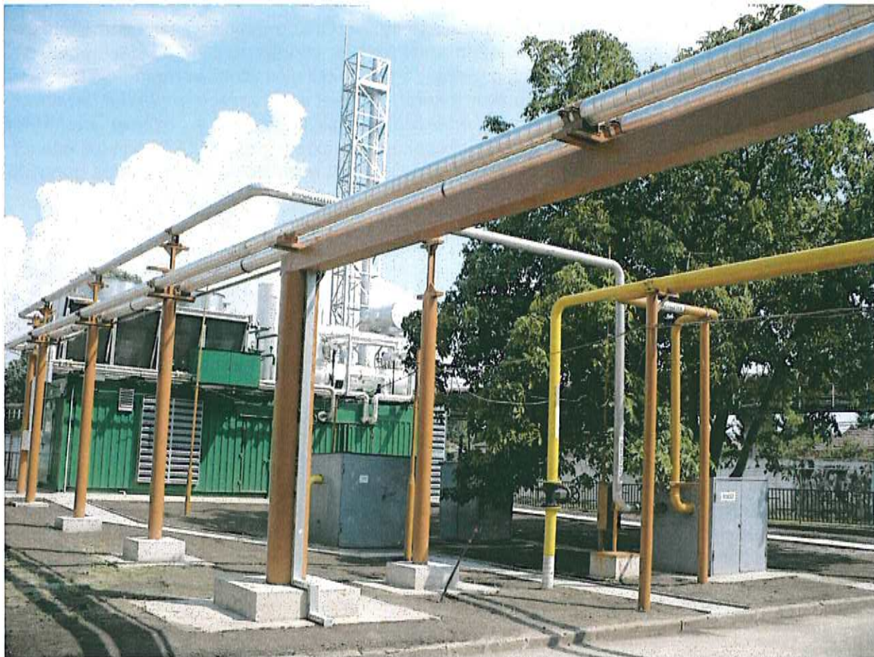
5. ábra: Futó utcai kazánház területén működő biogázmotoros erőmű
