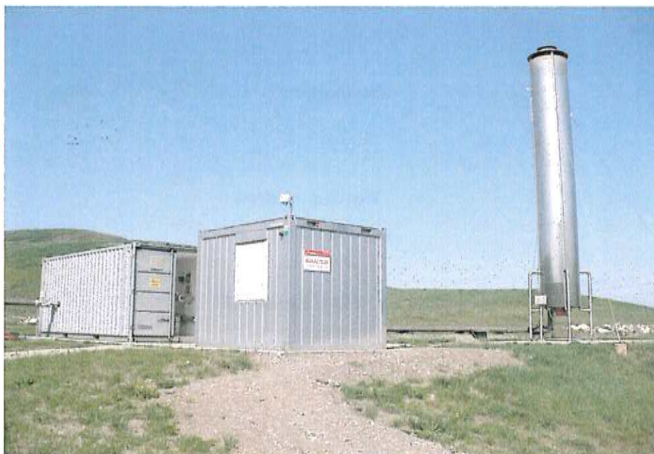
2. ábra: a metángáz semlegesítéséhez telepített berendezések
