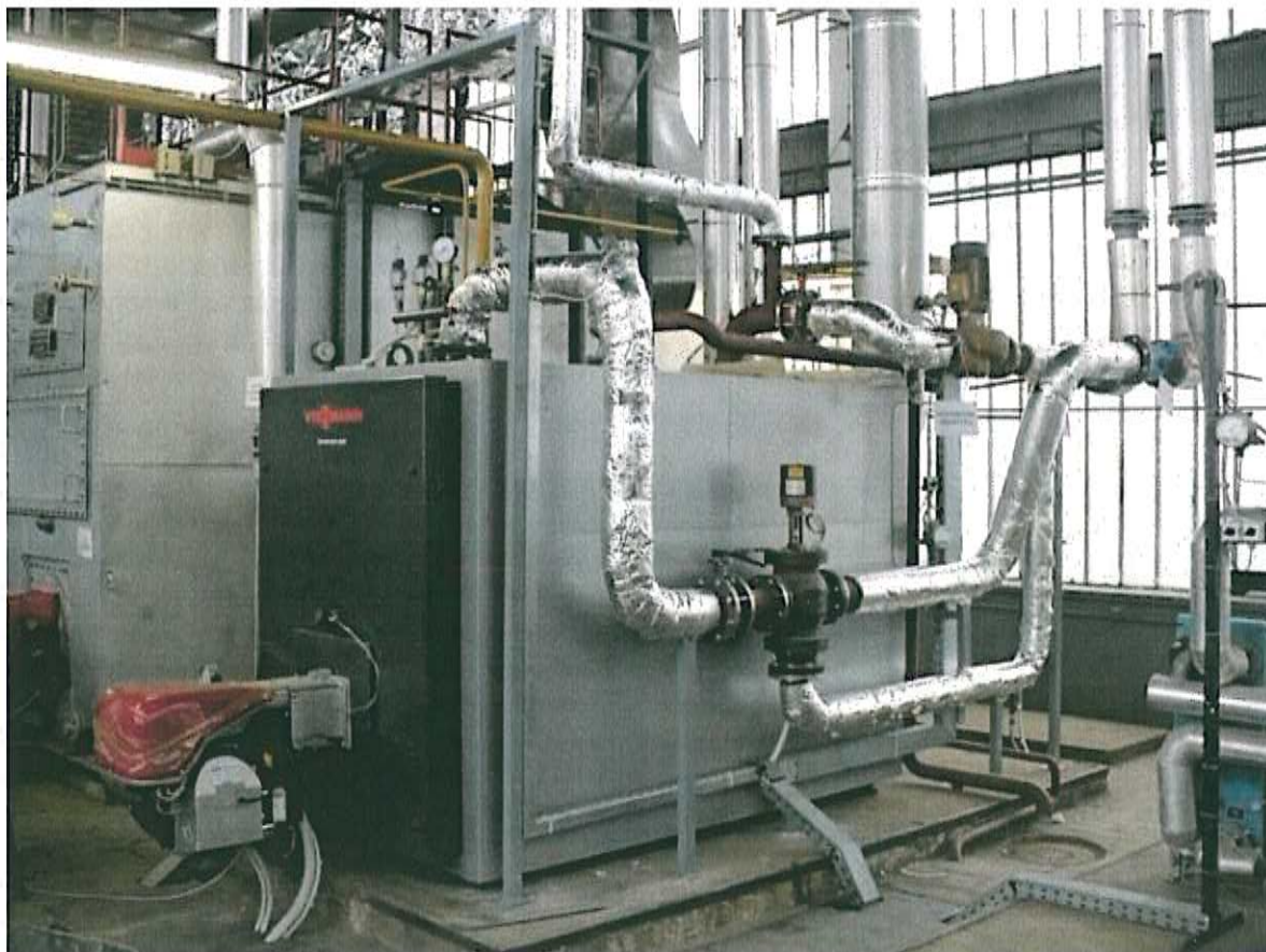
4. ábra: Korszerű biogáz üzemű kazán
