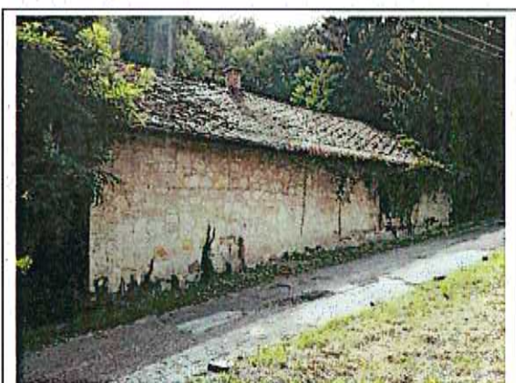
A bontásra szoruló épület utcai homlokzata
