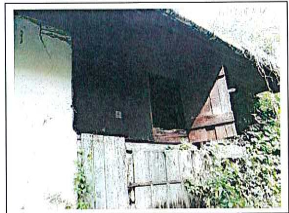
A bontásra szoruló épület udvari homlokzata
