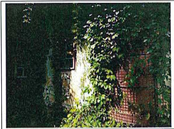
A bontásra szoruló épület udvari homlokzata
