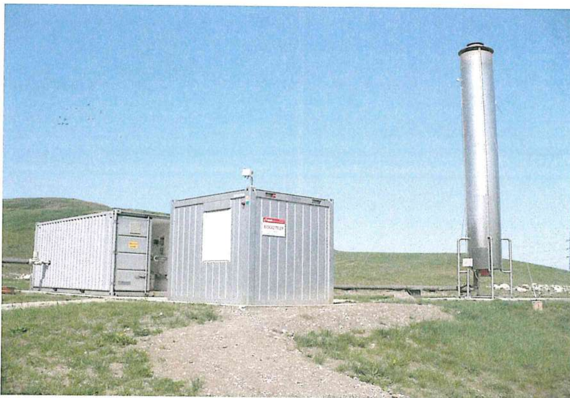
2. ábra: a metángáz semlegesítéséhez telepített berendezések
